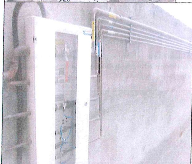
La linea in rosso evidenzia il percorso esterno delle tubazioni GM Tratto di impianto GM NF85.14104 (congiunzione iniziale)
